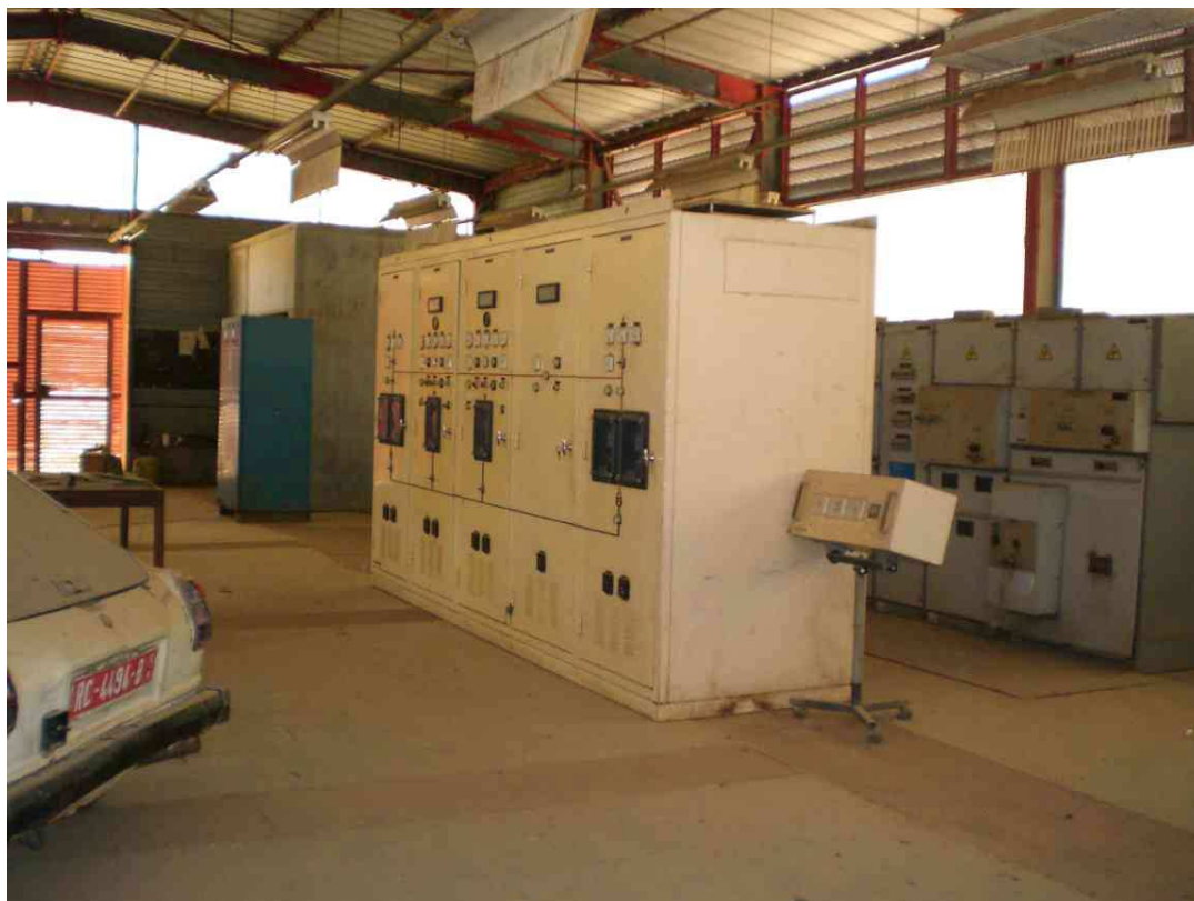
L'intérieur de la centrale
